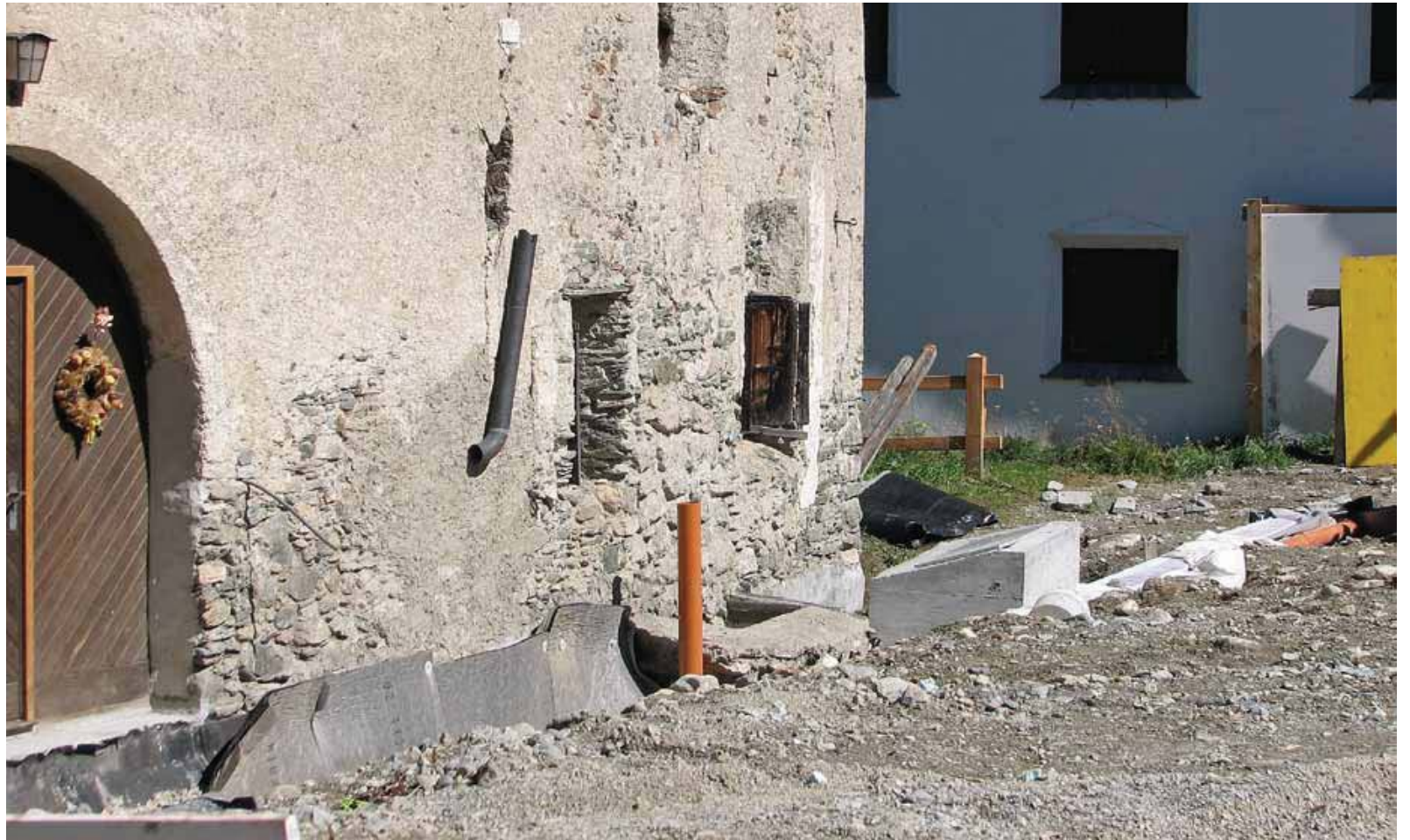
Die beschränkte Lebensdauer von Baumaterialien wie auch Bewegungen – beispielsweise eine Senkung – der Umgebung können auch bei solide gebauten Häusern im Sockelbereich aufwendige Sanierungsmassnahmen notwendig machen. Deshalb ist auf sorgfältige Planung und Ausführung grössten Wert zu legen. BILD HEV
